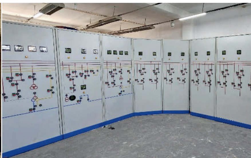
Модернизация защит и управления на ПСН 2 С и ПС «Левобережная»
