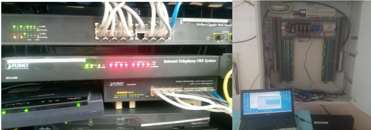
АТС IPX- 2100 в телекоммуникационном шкафу на ДП Шемонаихинского РЭС
