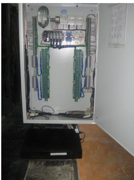
Шкаф телемеханики WP 8431 на ПС Чарск
